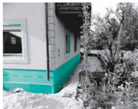
Mostki termiczne w wnękach okiennych i drzwiowych i termoizolacja cokołu z FIBRANxps ETICS .
